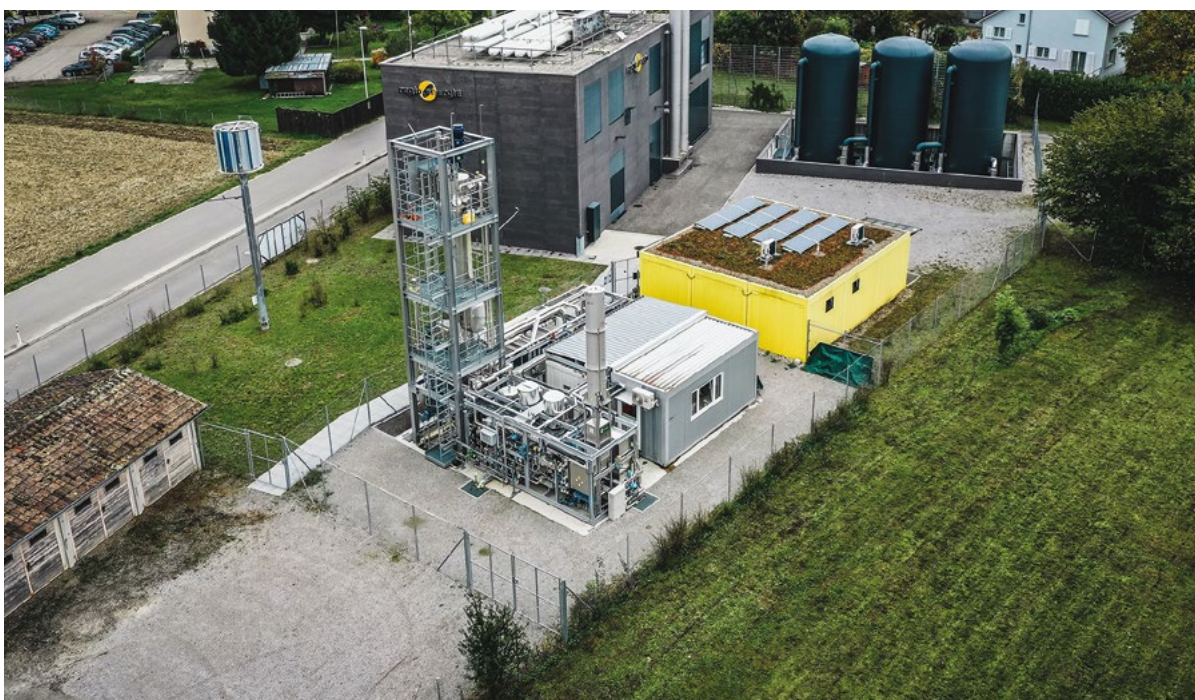
L'installation de méthanation à Soleure, qui a été construite dans le cadre du projet « STORE & GO » du programme « Horizon 2020 ». Au total, 27 partenaires originaires de six pays européens ont pris part au projet. Photo : Regio Energie Solothurn
