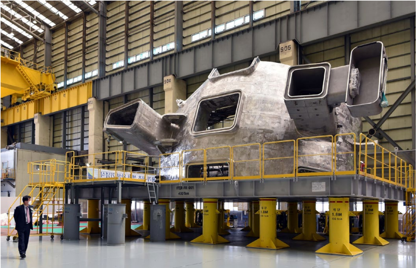
Der erste Teil der in Südkorea zusammengebauten Vakuumkammer von ITER. Er ist 14 Meter hoch, wiegt 440 Tonnen, weist 1380 Meter Schweissnähte auf und entspricht strengsten Nuklearstandards. Foto: zVg
